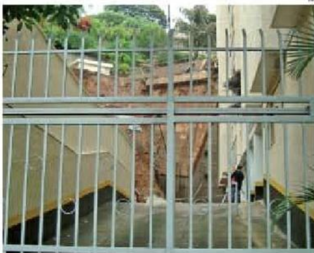
Muro de contenção ficou dependurado entre as edificações
