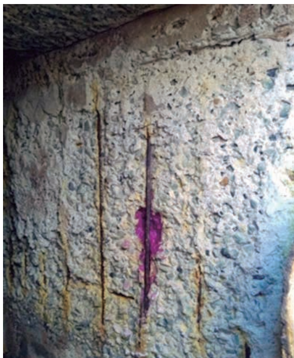
Figura 1 - Estrutura interna bastante degradada. Fonte - pp. autor (2019).
