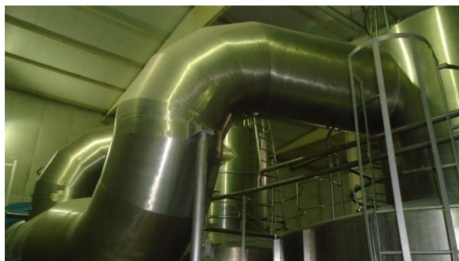
Figura 4 – Sistema de Secagem Nível 3 Fonte: Autores
