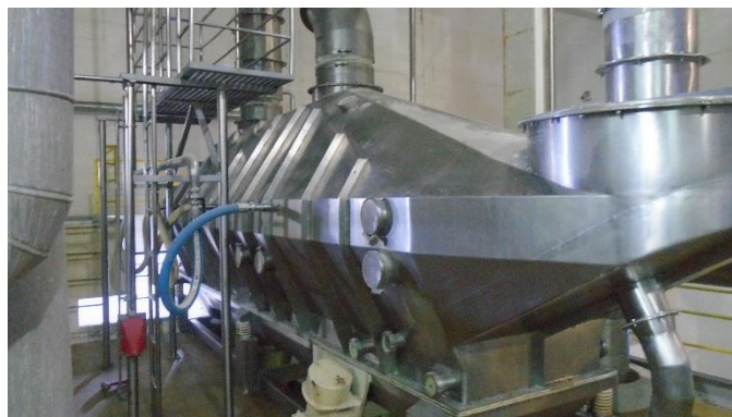
Figura 3 – Sistema de Secagem Nível 2 Fonte: Autores
