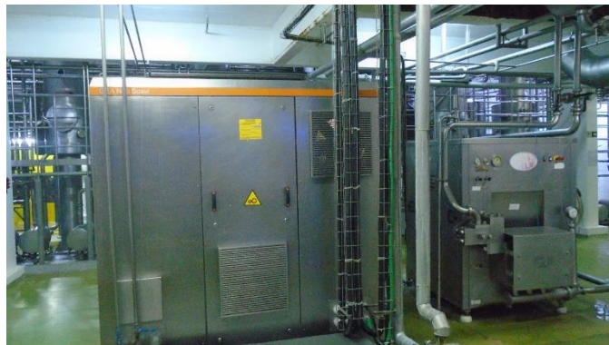
Figura 2 – Sistema de Secagem Nível 1 Fonte: Autores
