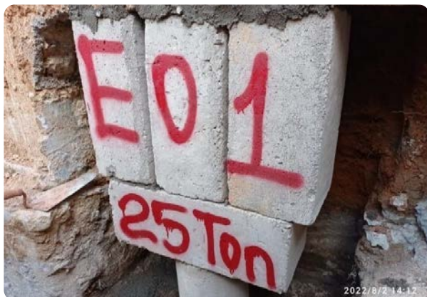
Imagem 9 - Estaca mega já cravada e cunhada no cintamento existente, identificada e com a informação da carga de reação
