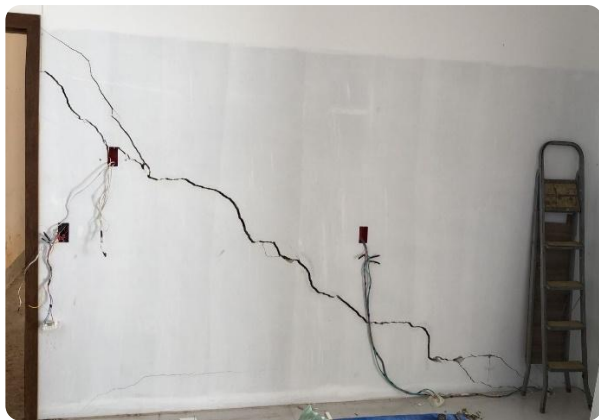
Imagem 11 - Rachadura encontrada em parede do pavimento térreo
