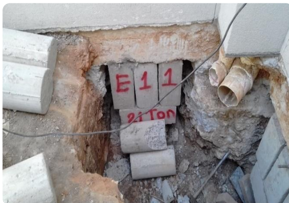
Imagem 10 - Outra estaca já cravada e cunhada no cintamento existente, identificada e com a informação da carga de reação
