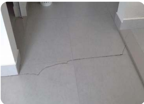
Imagem 5 - Rachadura encontrada no hall de circulação do pavimento térreo
