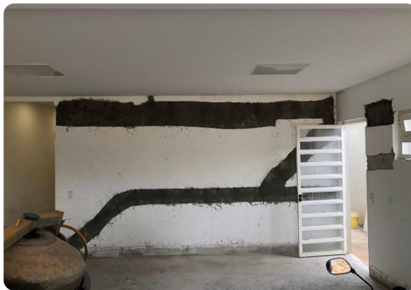
Imagem 12 - Fissura/rachadura já tratada na garagem do subsolo
